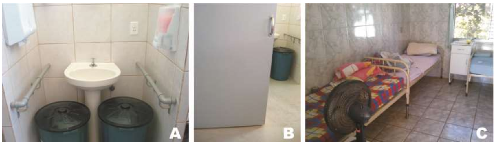
Figura 2: registros fotográficos de instalações parcialmente adequadas nas ILPI no ano de 2013. Araçatuba, SP- Brasil. A – Cesto de lixo atrapalhando o acesso a pia / B – porta do banheiro sem vão livre / C – Camas não estão distanciadas da maneira adequada
